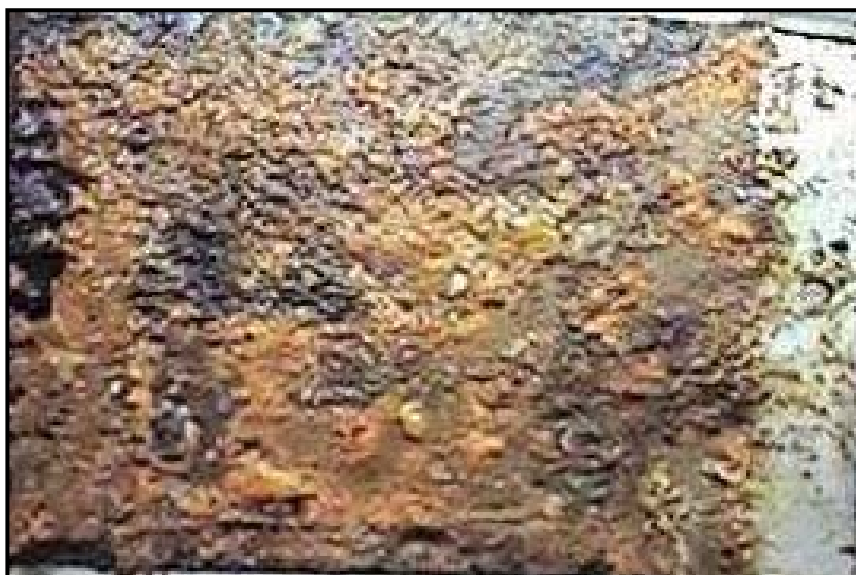
Figura 14 – Aspecto de um painel controle após a retirada das telas.
