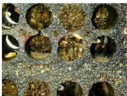
Figura 9. Entupimento de Dutos.
