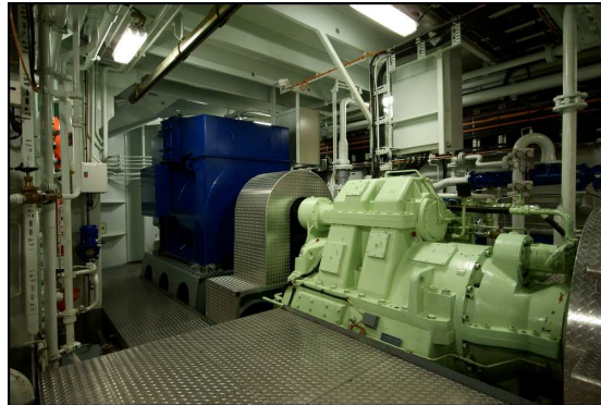
Fig. 6 – Gerador de Eixo
