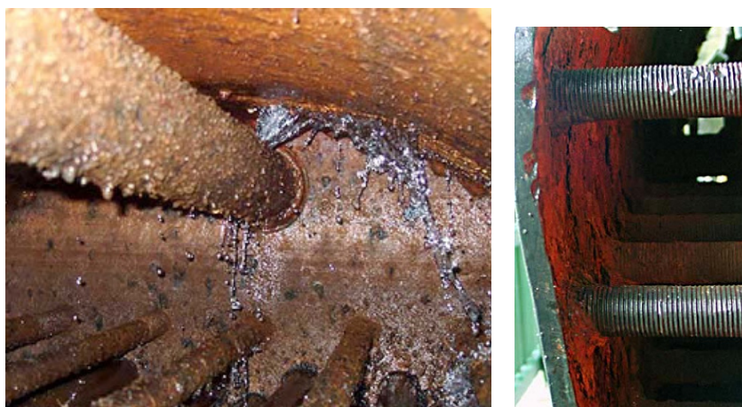
Figura 1: Avarias provocadas nas canalizações e máquinas pela corrosão.
