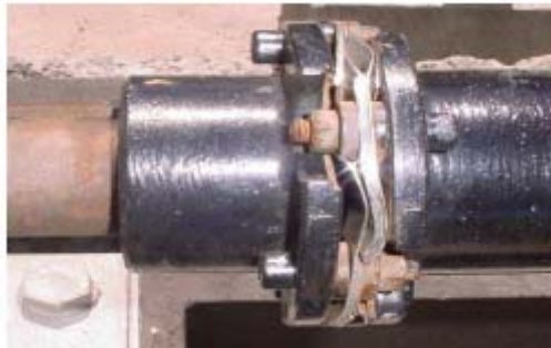
Figura 10 - Acoplamento danificado por desalinhamento
