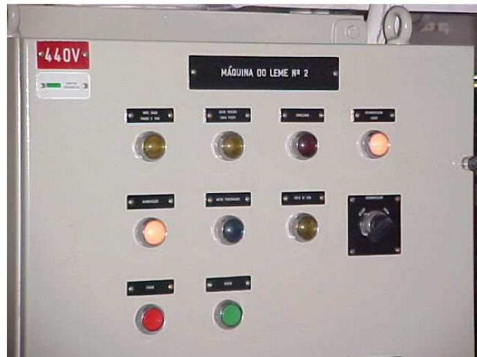
Figura 3: ARMÁRIO DO CONTROLADOR DA BOMBA Nº 2 DA MÁQUINA DO LEME
