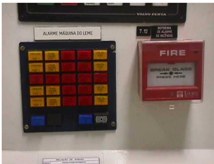
Figura 10 – ALARMES DO SISTEMA DE GOVERNO
