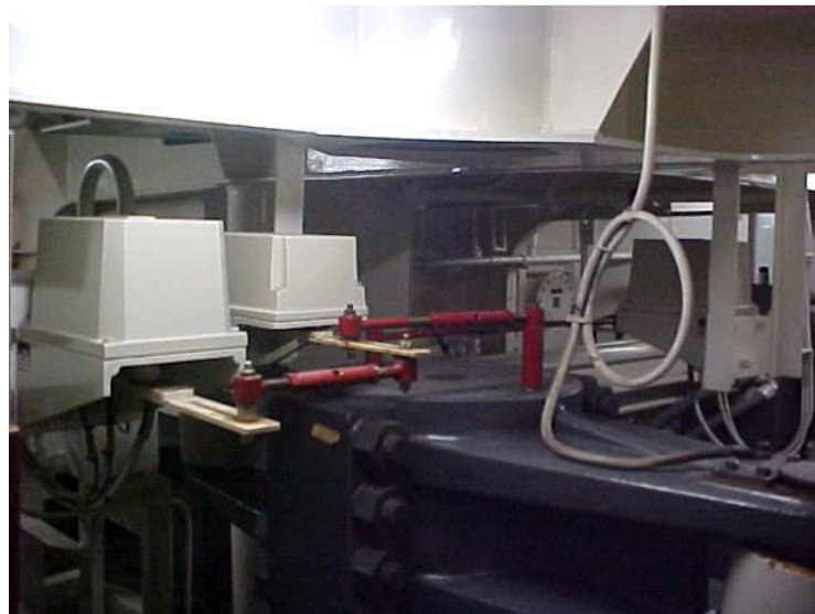
Figura 8 – CAIXAS DOS SINCROS DO SISTEMA DE GOVERNO.
