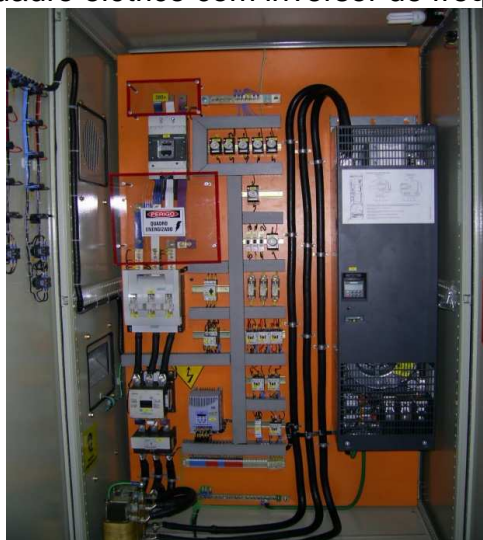
Figura 6: Quadro elétrico com inversor de frequência
