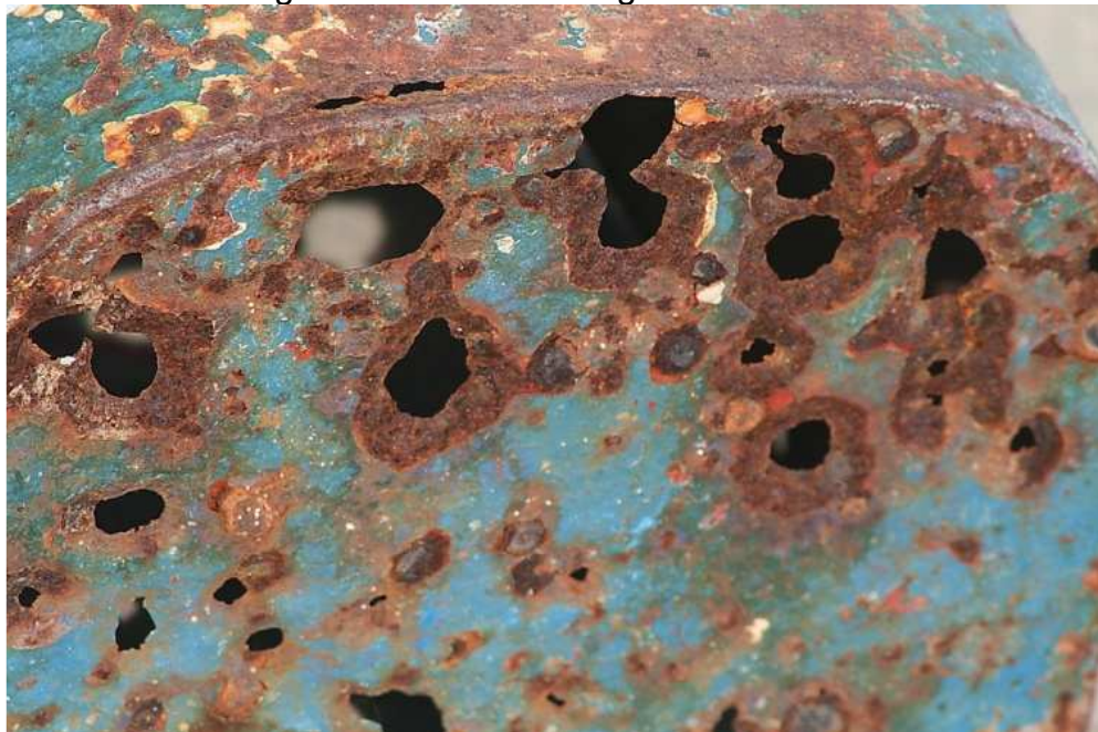
Figura 2: Efeito da ferrugem e corrosão
