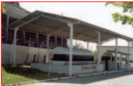
Tanques de combustível
