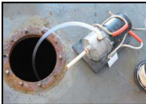
Figura 9. Bomba para coleta de água
