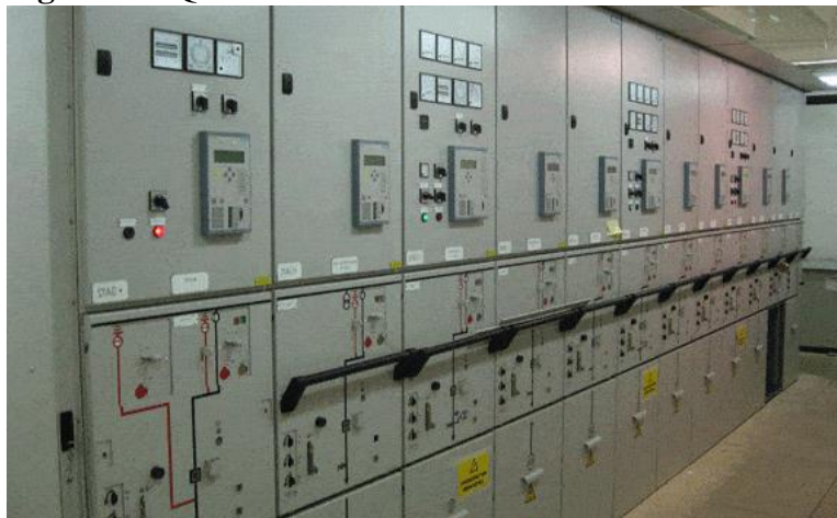
Figura 14: Quadro elétrico marítimo
