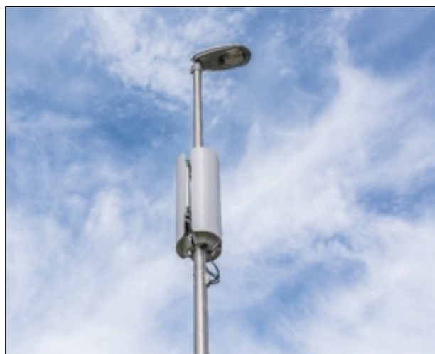
Figura 04 – Small Cell instalada em poste de luz.
