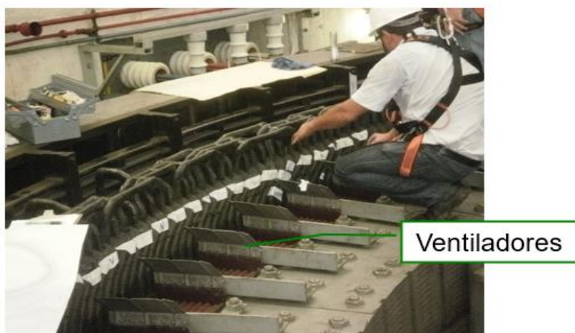
FIGURA 11 - SISTEMA DE VENTILAÇÃO ACOPLADO AO ROTOR DO GERADOR.
