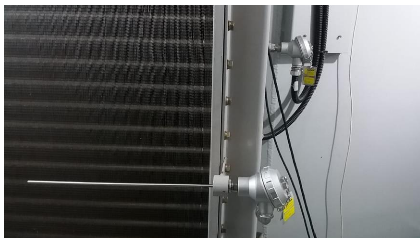
FIGURA 57 - TERMORRESISTÊNCIAS INSTALADAS EM UM RADIADOR PARA MEDIÇÃO DE AR QUENTE E FRIO.
