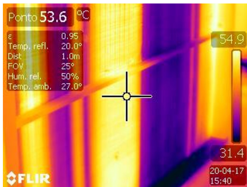
FIGURA 49 - TERMOGRAFIA DE UM RADIADOR DO GERADOR COM ALTO NÍVEL DE OBSTRUÇÃO. TEMPERATURA LIDA = 53,6°C.
