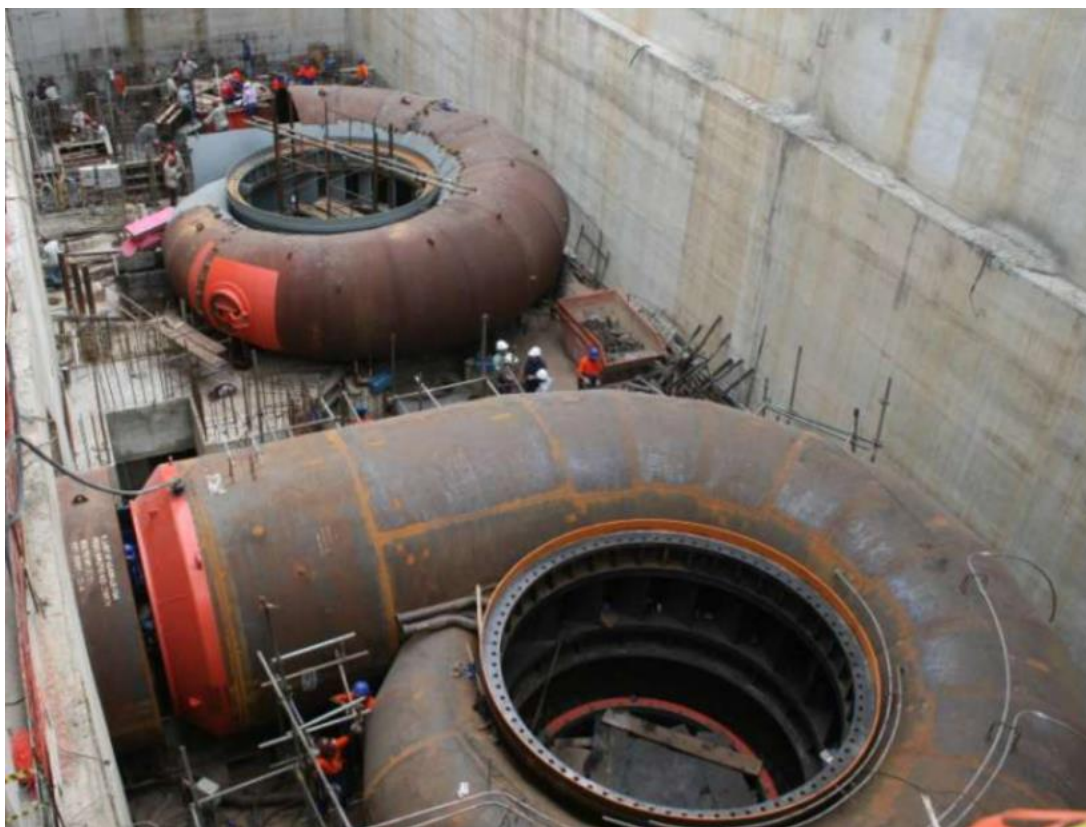
FIGURA 38 - CAIXA ESPIRAL USINA HIDRELÉTRICA SIMPLÍCIO
