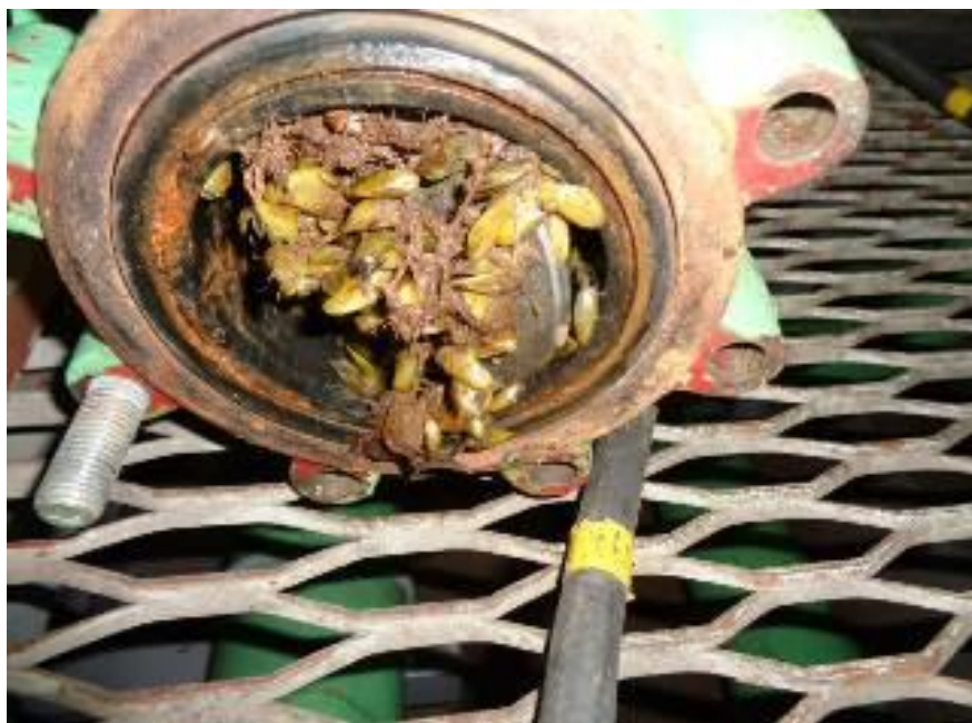
FIGURA 46 - MEXILHÃO NA TUBULAÇÃO DO SISTEMA DE RESFRIAMENTO DA USINA.
