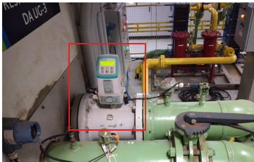
FIGURA 55 - SENSOR PARA MEDIÇÃO DA VAZÃO DE ÁGUA DO SISTEMA DE RESFRIAMENTO DO GERADOR.
