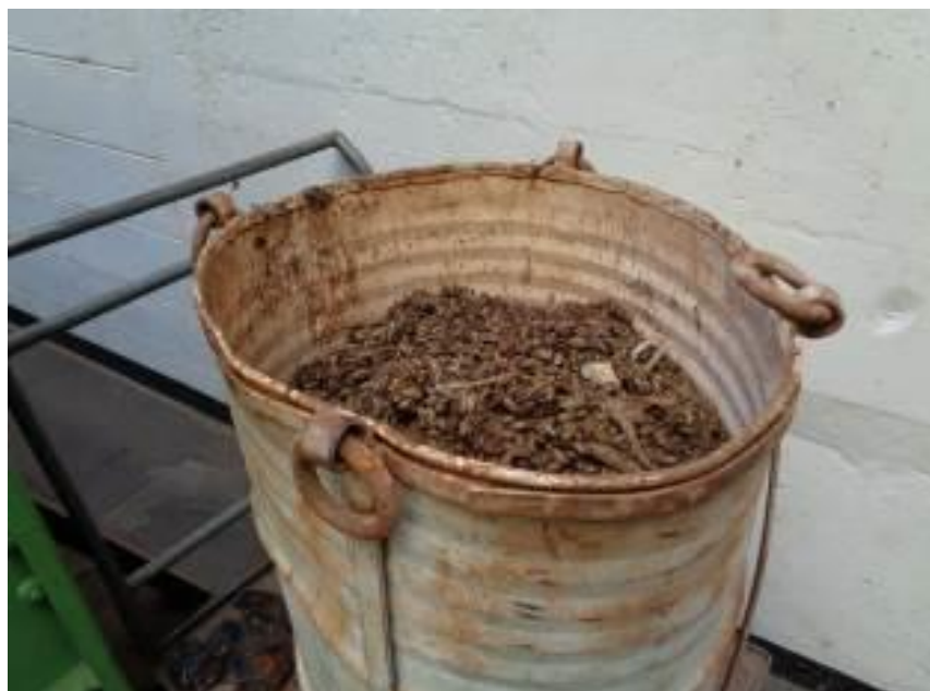
FIGURA 45 - MEXILHÃO RETIRADO DO FILTRO DO SISTEMA DE RESFRIAMENTO DA USINA.
