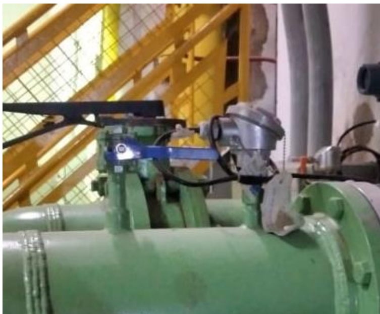
FIGURA 52 - TERMORRESISTÊNCIA PARA MEDIÇÃO DA TEMPERATURA DA ÁGUA DE ENTRADA DO SISTEMA DE RESFRIAMENTO DA UG3 DA UHE NOVA AVANHANDAVA.
