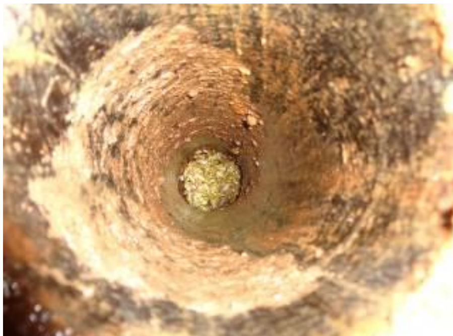
FIGURA 47 – MEXILHÃO NA TUBULAÇÃO DO SISTEMA DE RESFRIAMENTO DA USINA.
